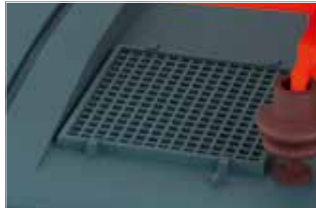
Mit zusätzlichen Dachlüftern
